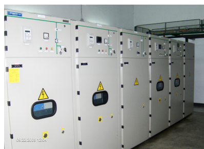
Stația de la Mărtinești: Stația de medie tensiune reabilitată
